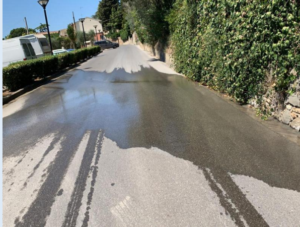
Esempio di perdite di rete e allagamento stradale
